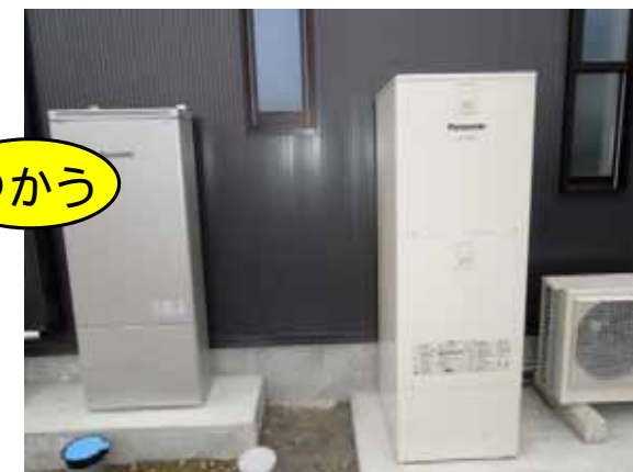
パワーステーション
